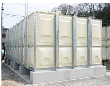
災害時に水を確保する貯水システム 「貯得（ためとく）※6」
